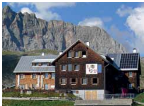
Freiburger Hütte Photovoltaikanlage
